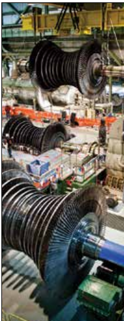
Plataforma de turbinas
