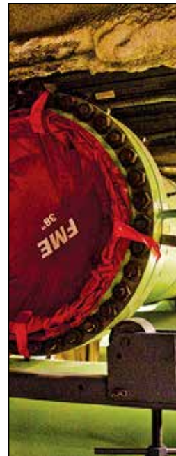
Instrumentation et contrôle
