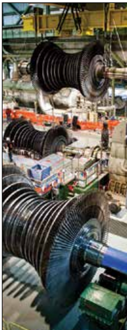
Salle des turbines
